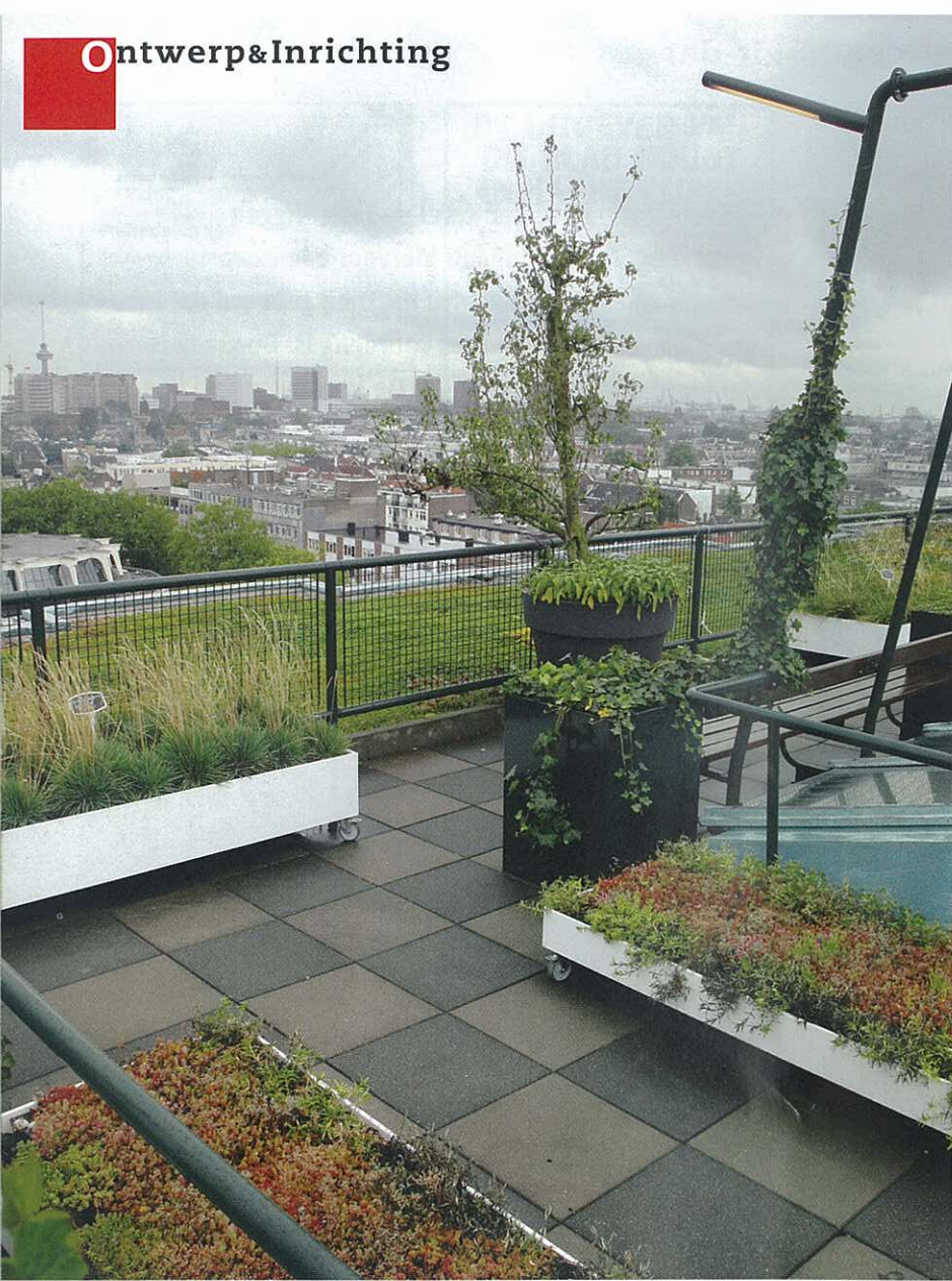
Het groene infodak laat zien dat zowel sedum als gras goed gedijt op het dak. Achter het hek het bestaande sedumdak; rechts een van de licht-groene lichtkoepels met bijbehorende verlichtingsstallage.
